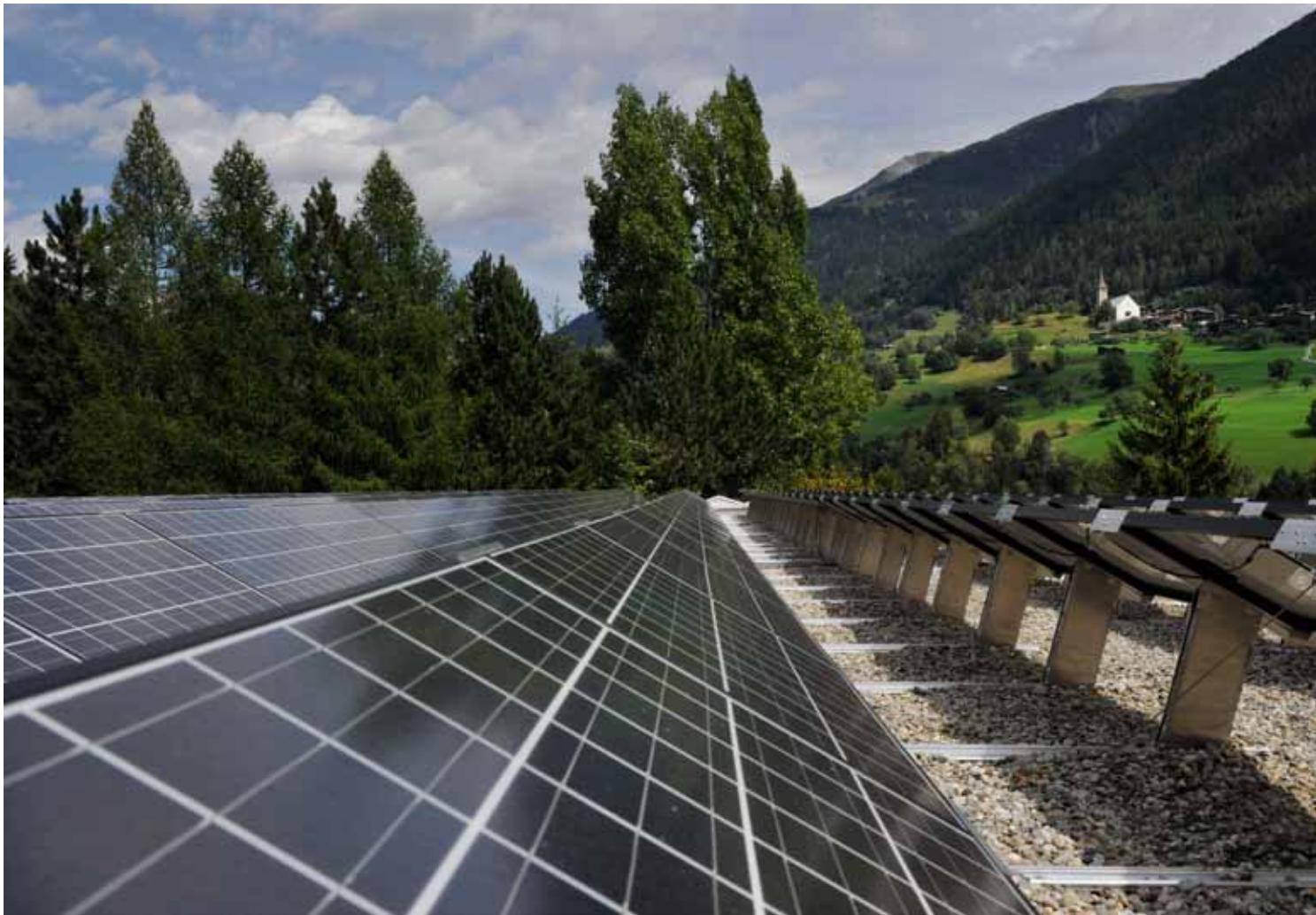
Solaranlage auf dem Dach der Fiescher Sporthalle. Im Hintergrund die Kirche von Ernen
