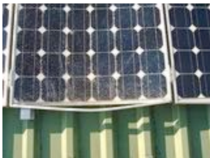
Abbildung 5: Durch Schneelast beschädigtes Modul [Quelle: solarserver]
